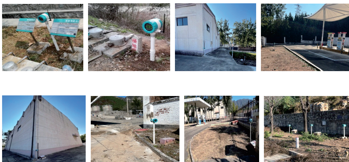
图 7 工程实例：MS5751 监测仪对接地系统的实时监测应用场景
